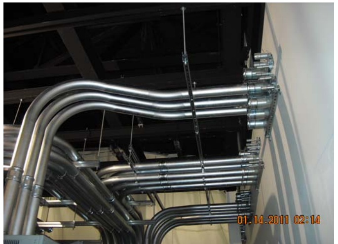
Conduits for Switchgear in RM 162
