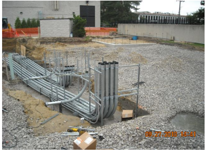
Genset Feeder Conduits
